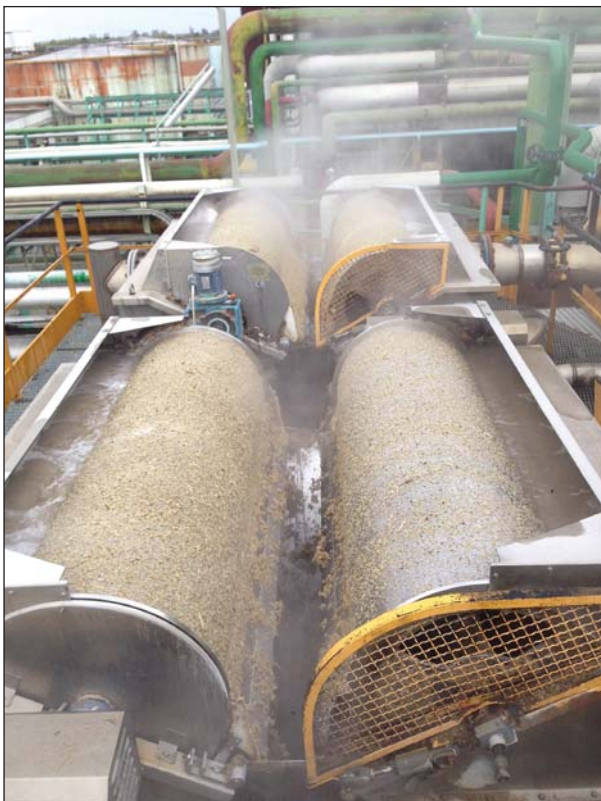
Fig. 8) Separatori di polpini dall'acqua di pressatura
